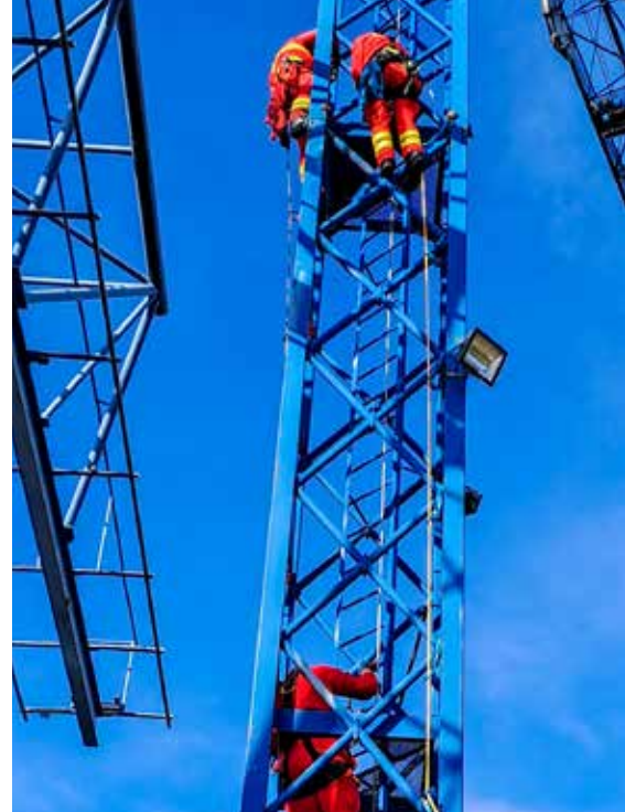
Absturzsicherung in schwindelnder Höhe.
